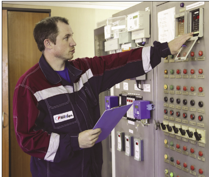
Автоматизированная система объединит 43 точки учета электроэнергии.
